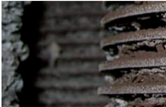
Vervuilde, met traditionele reinigingsmethoden moeilijk te reinigen installatiedelen
